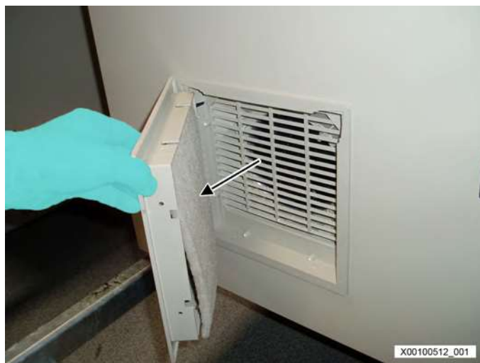
控制柜中的过滤器
