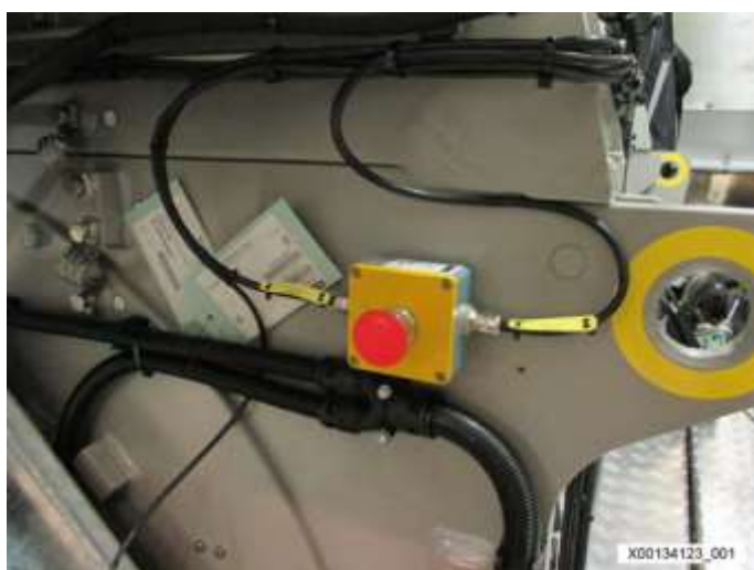
安装在发电机中的紧急停止按钮
