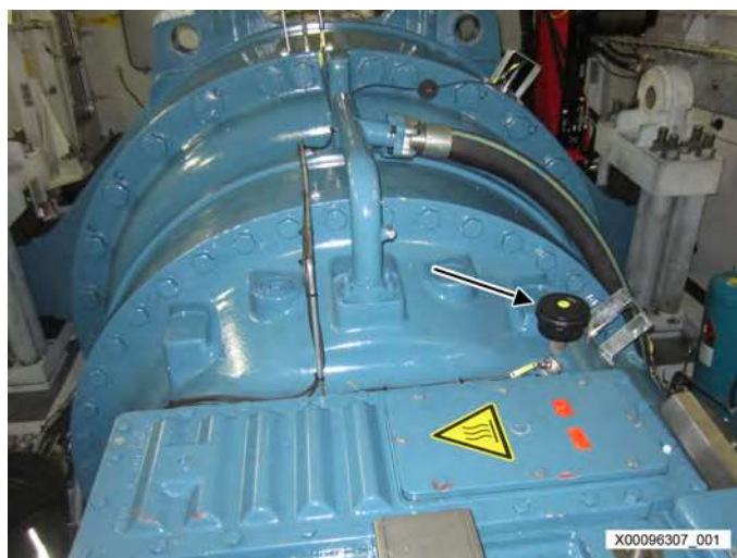
变速箱的空气过滤器
