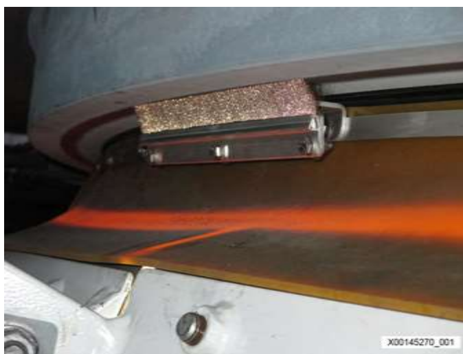
塔架和机舱之间的碳刷
