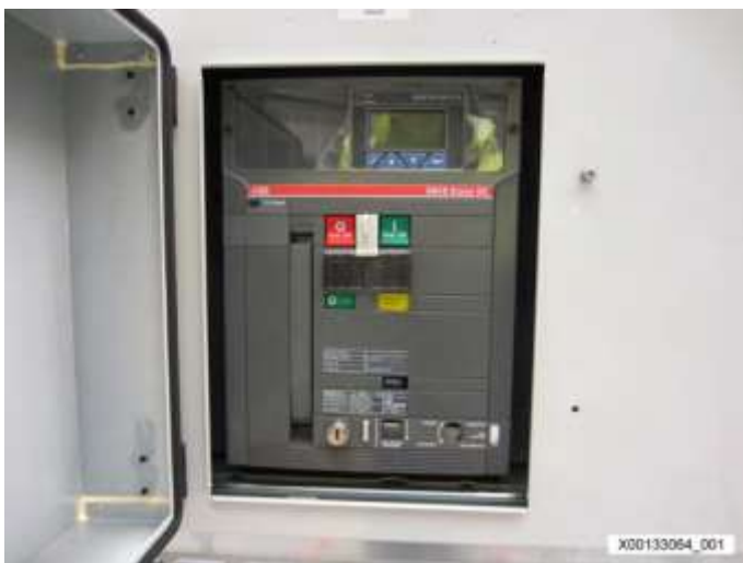
机舱用 690V 电源开关（A12 中的主断路器）
