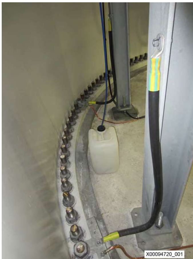
塔架和动力装置之间的接地电缆
