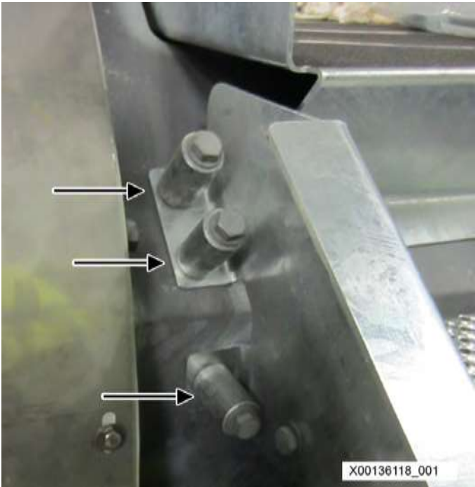
两级板左侧的三个螺栓
