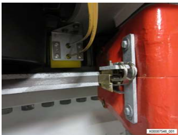
机舱底座和塔架之间的碳刷
