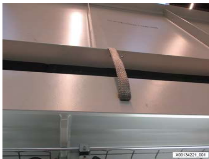
机舱和舱门之间的避雷装置
