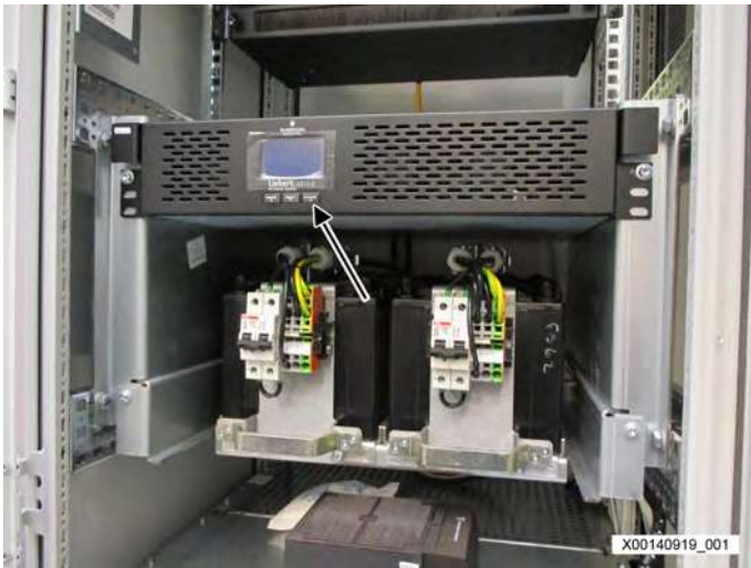
Liepert UPS，带 EnerSys™ Genesis Purelead 电池
