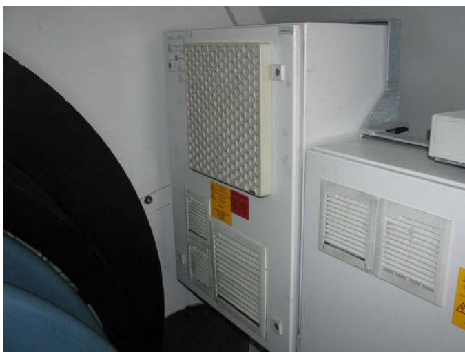
控制箱 A18 中的过滤器和风扇
