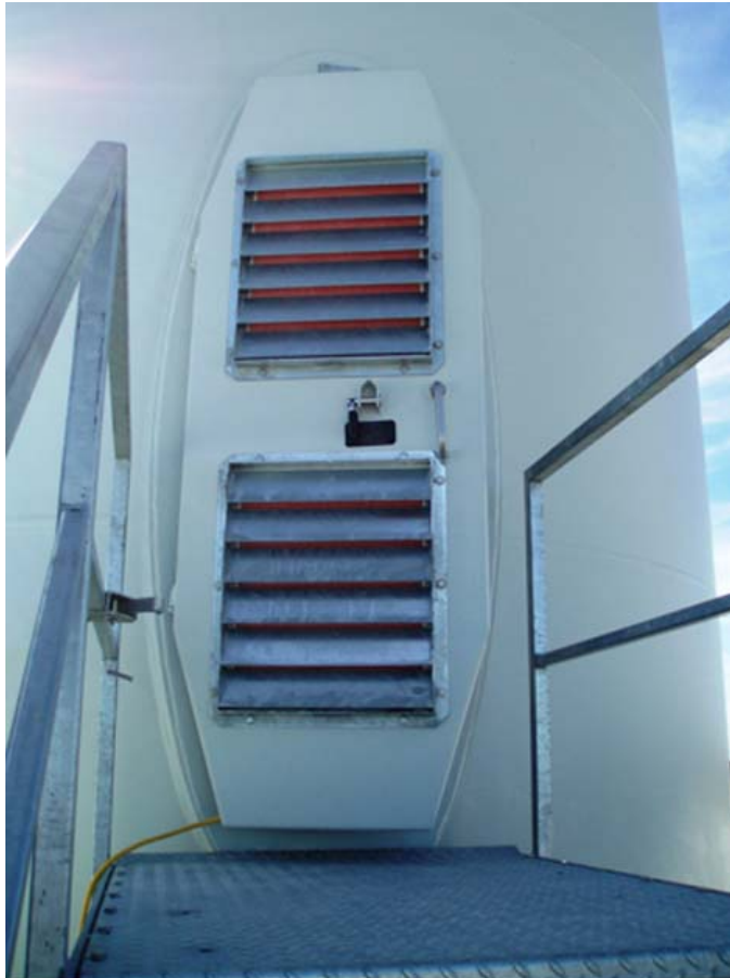
塔架门上的过滤垫
